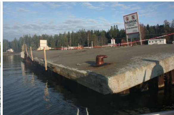
Sannas kollapsade kaj med angöringsförbud och rasrisk. Foto Ingeli Gagner 2011.
